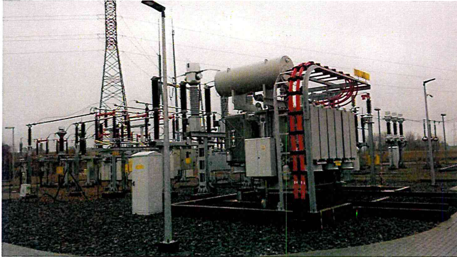
Transformator 110/20 kV i aparatura napowietrznej rozdzielni 110 kV
