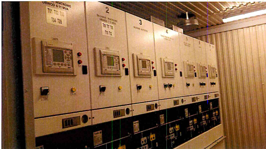
Wnętrzowa rozdzielnia 20 kV
