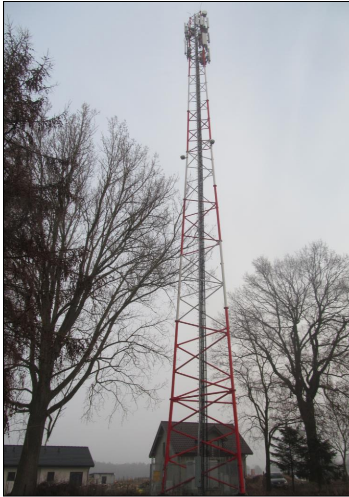
Zał. nr 1: Widok ogólny instalacji radiokomunikacyjnej.
