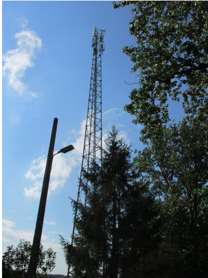
Zał. nr 1: Widok ogólny instalacji radiokomunikacyjnej.
